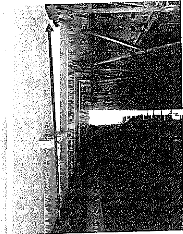
Fotografía N° 2, muros prefabricados de hormigón desaplomados eje Ha del edificio A, 17-11-2015.
